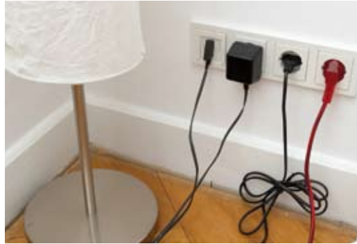
Neben Telefon- und TV-Anschlüssen sind genügend Steckdosen zu installieren.
