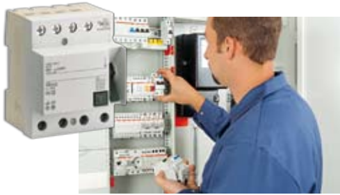
Ein FI-Schutzschalter in jedem Etagenverteiler verhindert, dass beim Ansprechen des „FI“, die gesamte Elektroanlage abgeschaltet wird.
