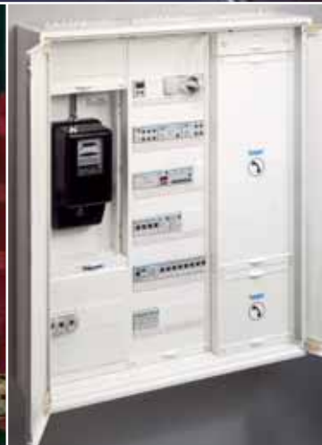
Sauber im Zählerschrank integriert: So sieht eine vorbildliche Installation aus.
