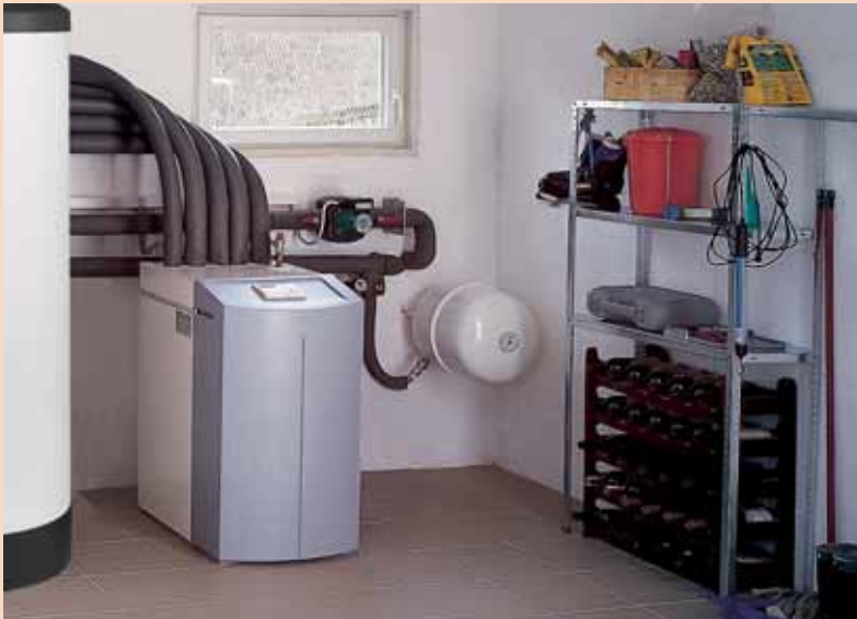
Eine Sole/Wasser-Wärmepumpe kann dank bester Schalldämmung auch im Hauswirtschaftsraum aufgestellt werden.
