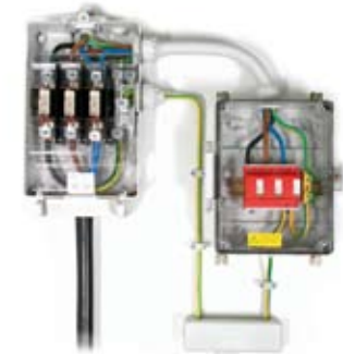
Blitzstrom-Ableiter schützen auch bei direktem Blitzschlag die Elektro-Installation
